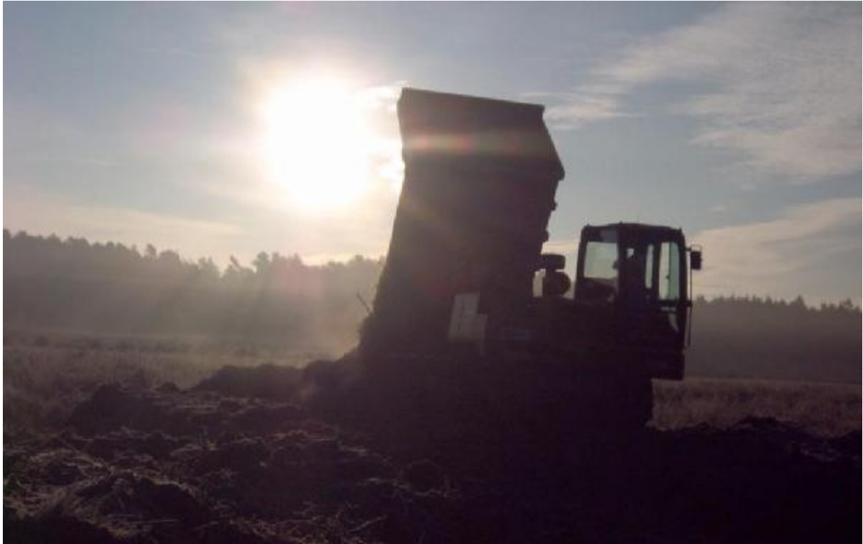
Abb. 15: Der Aushub aus den Gräben wird per Dumper am Rand der zentralen Wasserfläche abgelagert.
