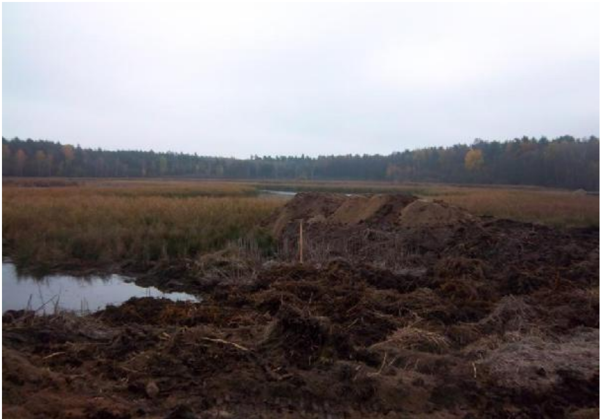
Abb. 16: Die zentrale Wasserfläche und der Grabenaushub zur Modellierung der Flachwasserzonen. Davor ein Pfosten mit der Markierung der angestrebten Wasserspiegelhöhe.
